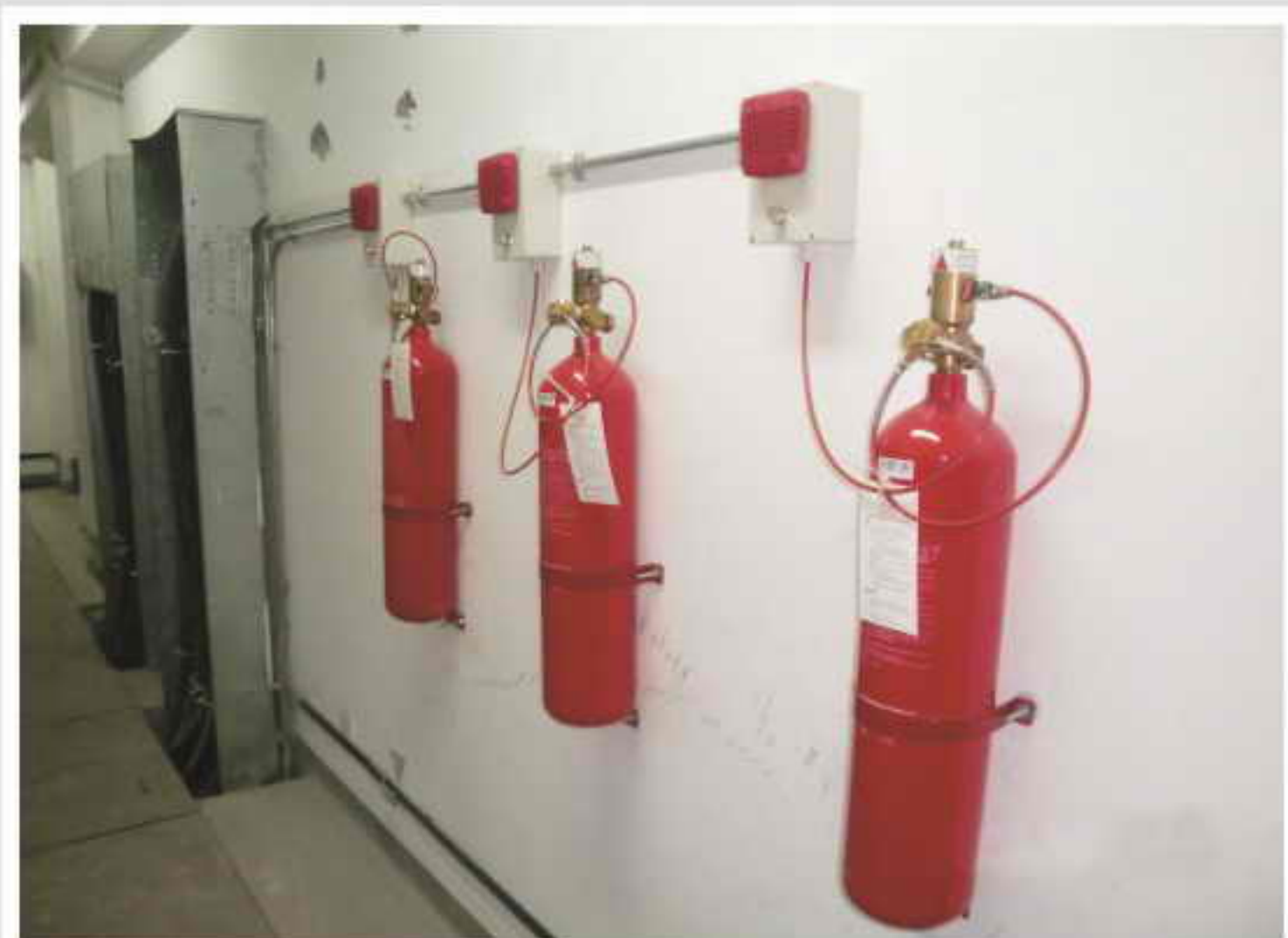
上海中一国际大厦配电室
