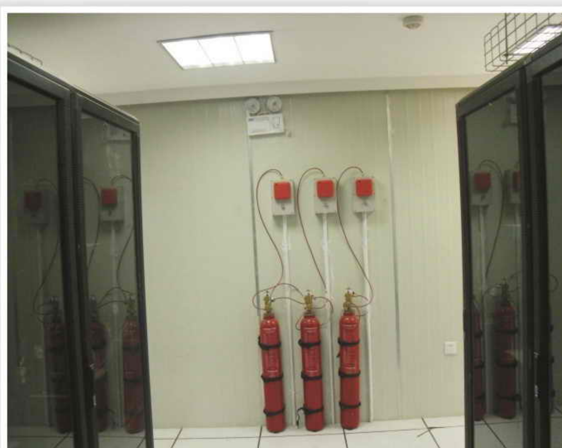
南昌机场二期中控室
