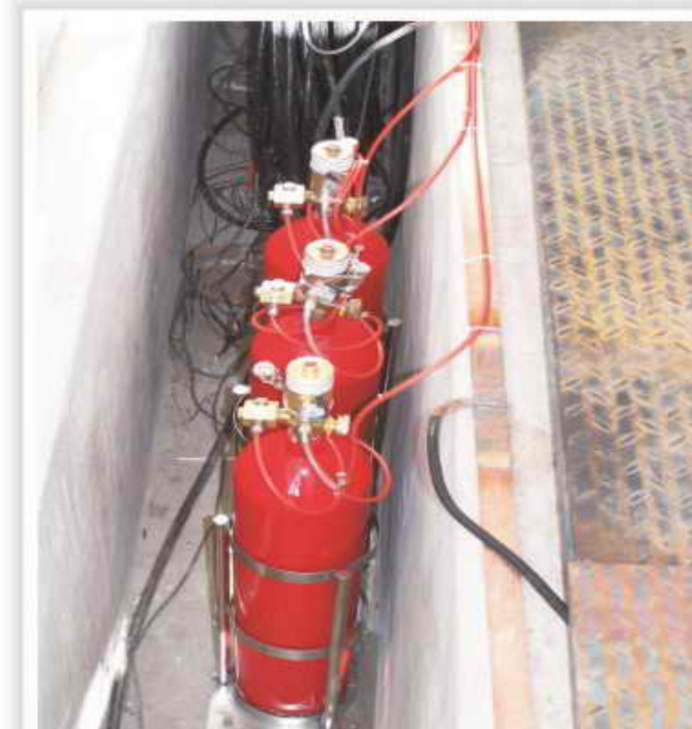
内蒙赤峰变电站
