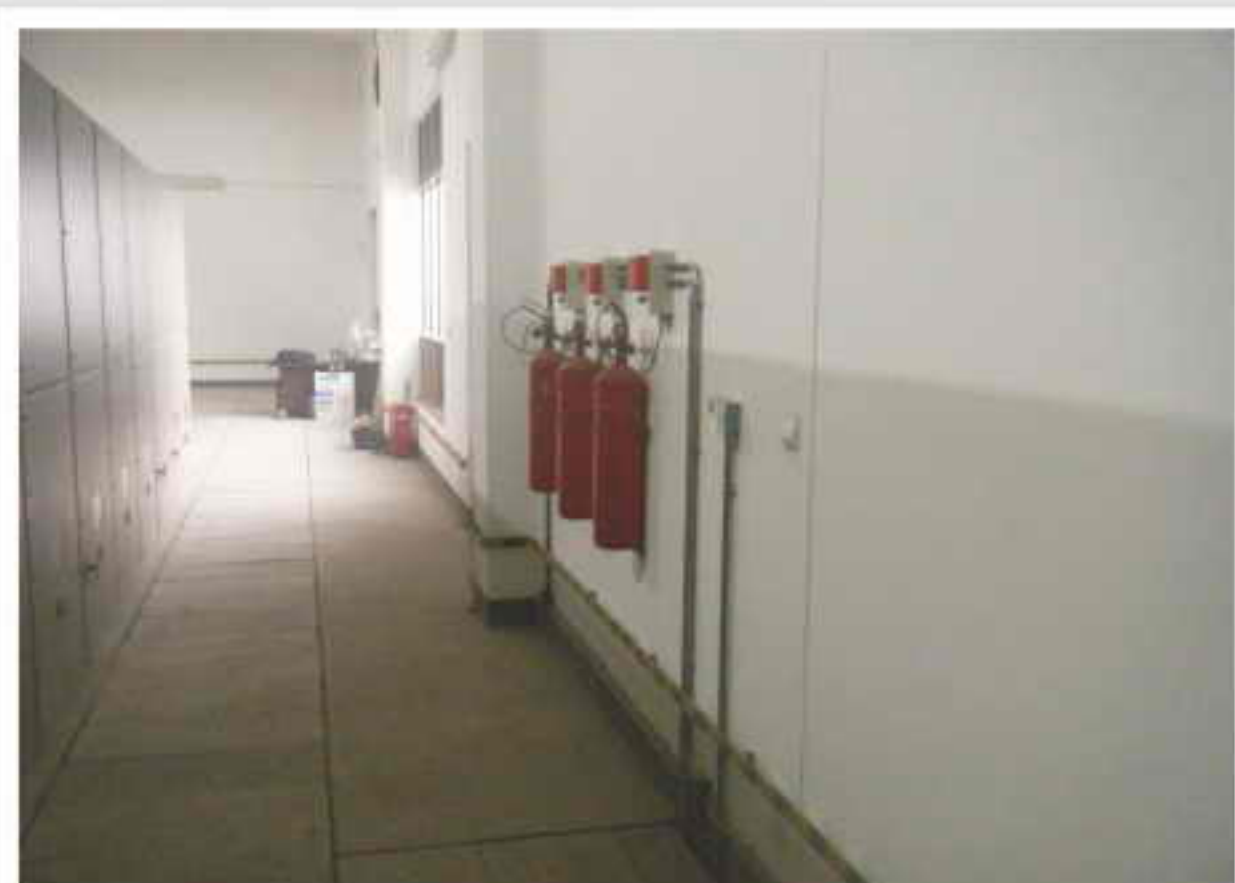
太仓NIKE物流中心配电室
